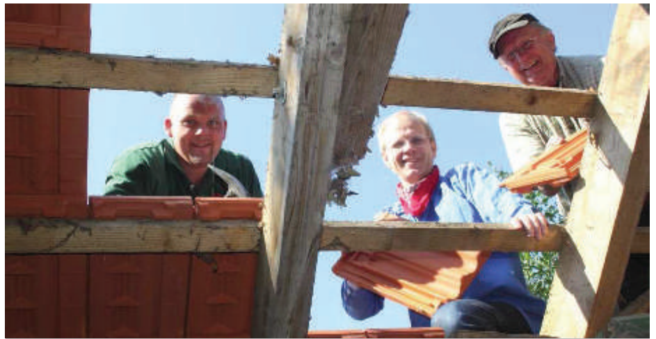
„Wir lassen `die Kraft der Sonne` herein“ Dachdeckermeister Sascha Lehmkuhl (l.), Vorstandsmitglied Karsten Bölling (m.) und Vorstandsvorsitzender Alfred Bölling Foto: Münstersche Zeitung
